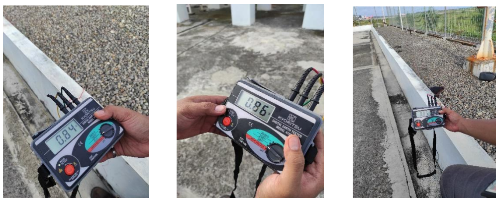
Gambar 2. Dokumentasi bentangan kabel Test Lead
